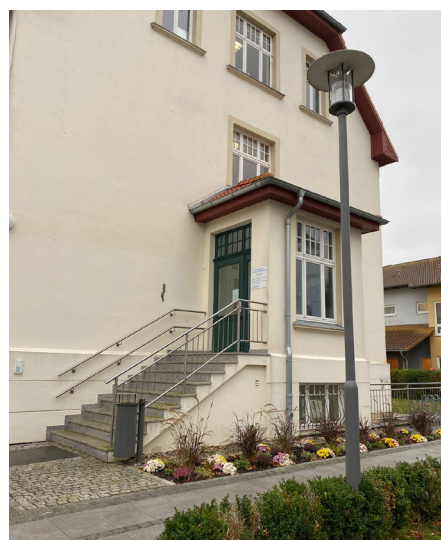
Der Außenfahrstuhl am Rathaus wurde vor mehreren Jahren demontiert - ein barrierefreier Zugang ist nicht möglich
